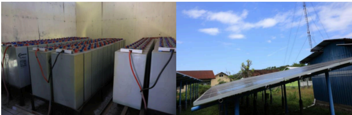
Gambar 9. Kondisi PLTS Komunal di Dusun Lepaloang
